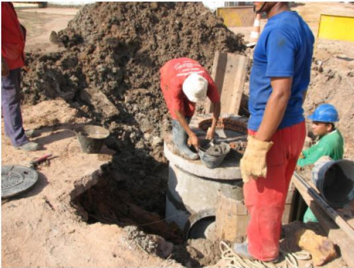
Foto – Argamassa em desacordo com NBR
