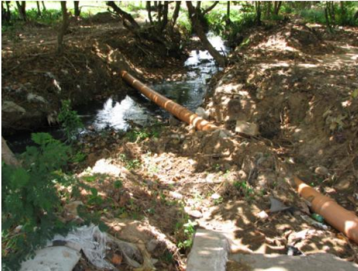
Foto - Tubulação aérea em PVC
