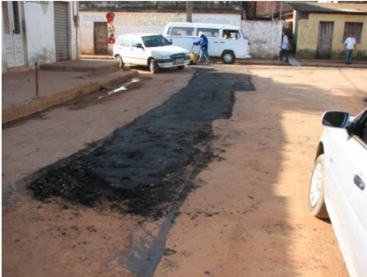
Foto – Execução inadequada da pavimentação
